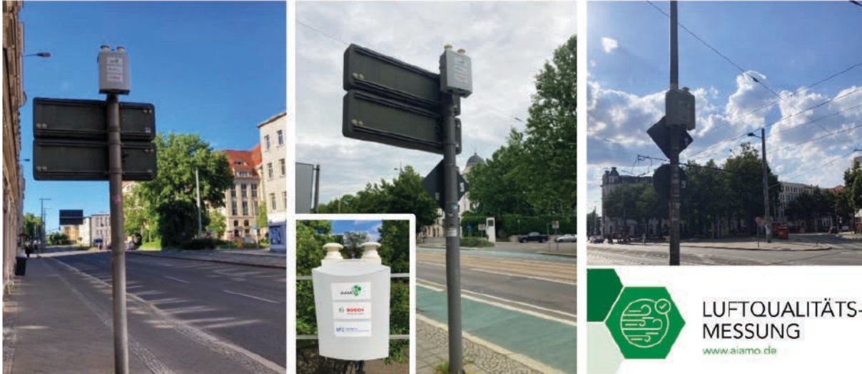
Abb. 1: IMB (Immission Monitoring Box) Luftqualitätssensor der Firma Bosch und Installationen an Parkleitsystemen und Stadtlaternen
